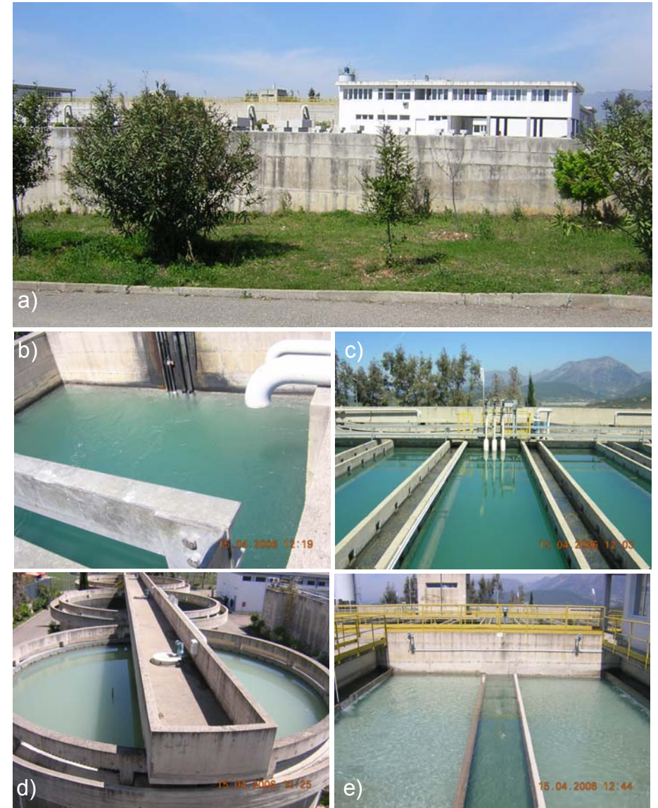
Figura 10-7. a) Pamje nga jashtë e ndërtesës qendrore të Impjantit të Përpunimit të Ujit të Bovillës, Kodra e Kuqe, Tiranë; b) Partitori; c) Flokulatori; d) Dekantuesi; e) Filtri. / a) Outside view of the main buildings of the Bovilla Water Treatment Plant, Kodra e Kuqe, Tirana; b) Partition; c) Flocculation; d) Decantation; e) Filtration (Photos: Buzo & Hoxha).
